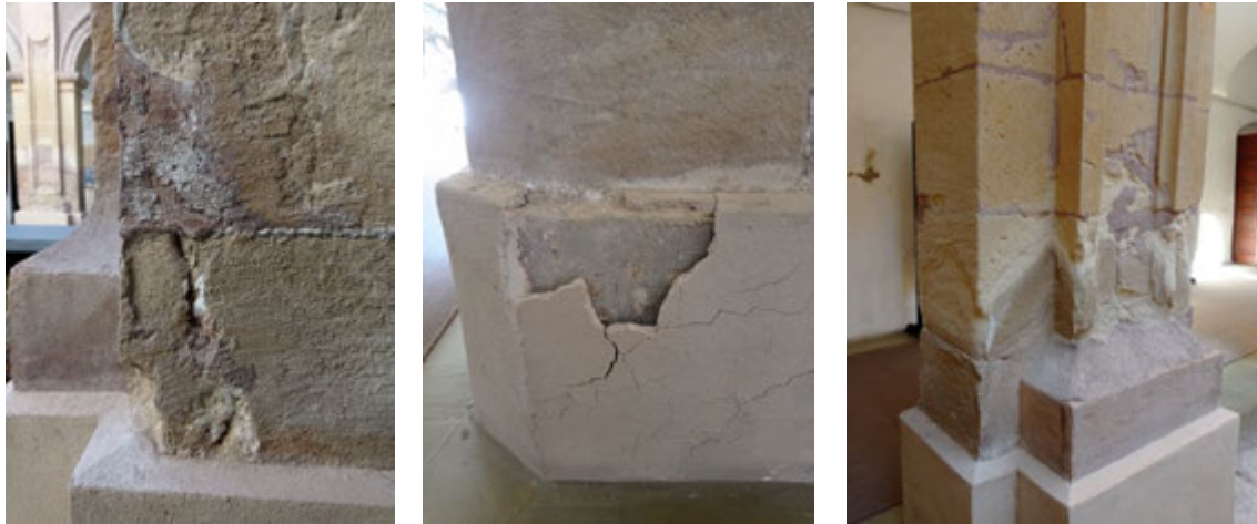
Figura 69, 70, 71. Detalles de algunas patologías detectadas en el claustro del convento.
